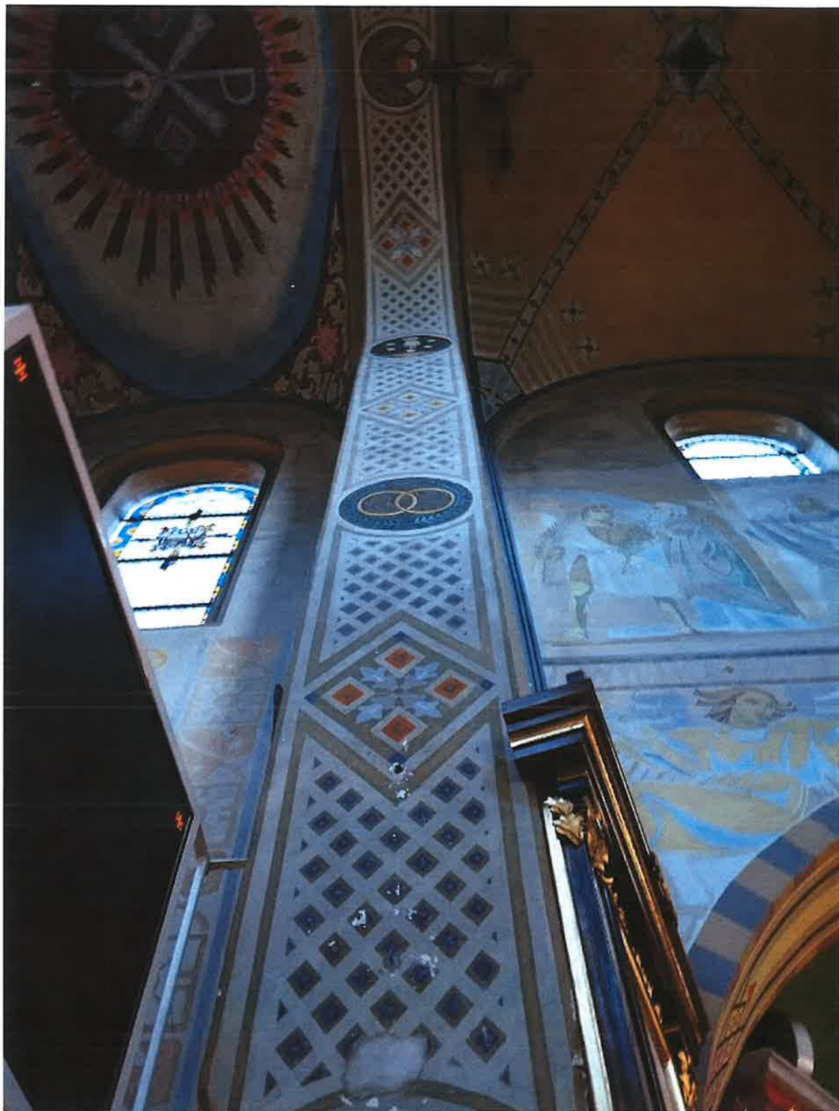
Fot. 26. Tarnawa Dolna. Kościół parafialny p.w. Św. Jana Kantego. Wnętrze. Fragment łuku tęczowego z symbolami sakramentów, strona południowa. Widoczne zabrudzenia powierzchni polichromii oraz zniszczenia warstwy malarskiej.
