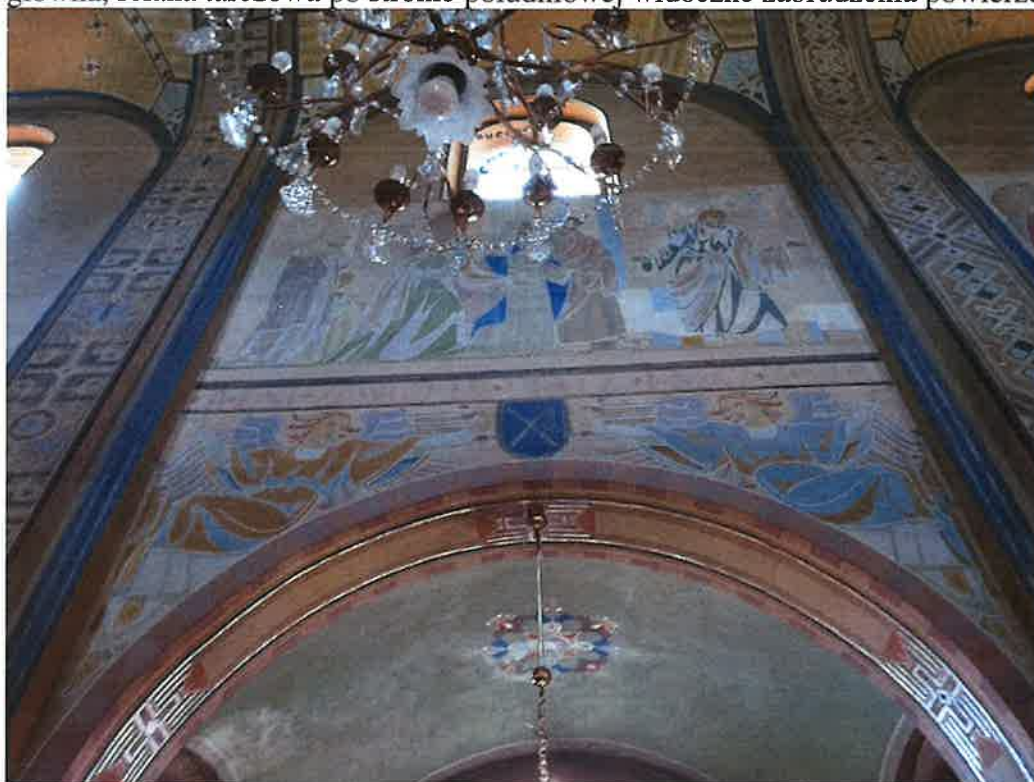
Fot. 8. Tarnawa Dolna. Kościół parafialny p.w. Św. Jana Kantego. Wnętrze. Nawa główna, ściana tarczowa po stronie północnej widoczne zabrudzenia powierzchni. Widoczne zniszczenia malatury na sklepieniu nawy bocznej
