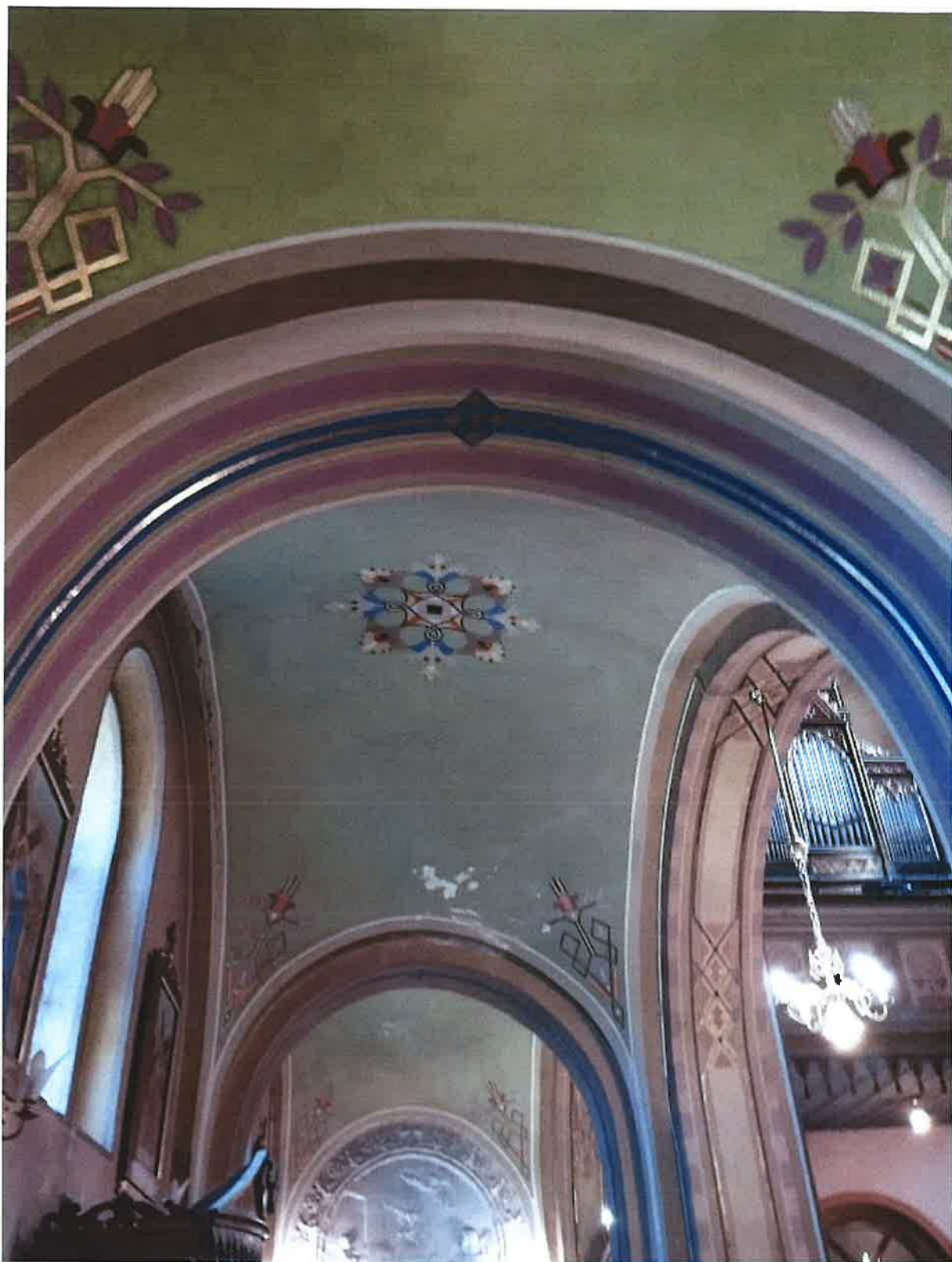
Fot. 30. Tarnawa Dolna. Kościół parafialny p.w. Św. Jana Kantego. Wnętrze. Fragment sklepienia nawy bocznej po stronie południowej. Widoczne zniszczenia warstwy malarskiej
