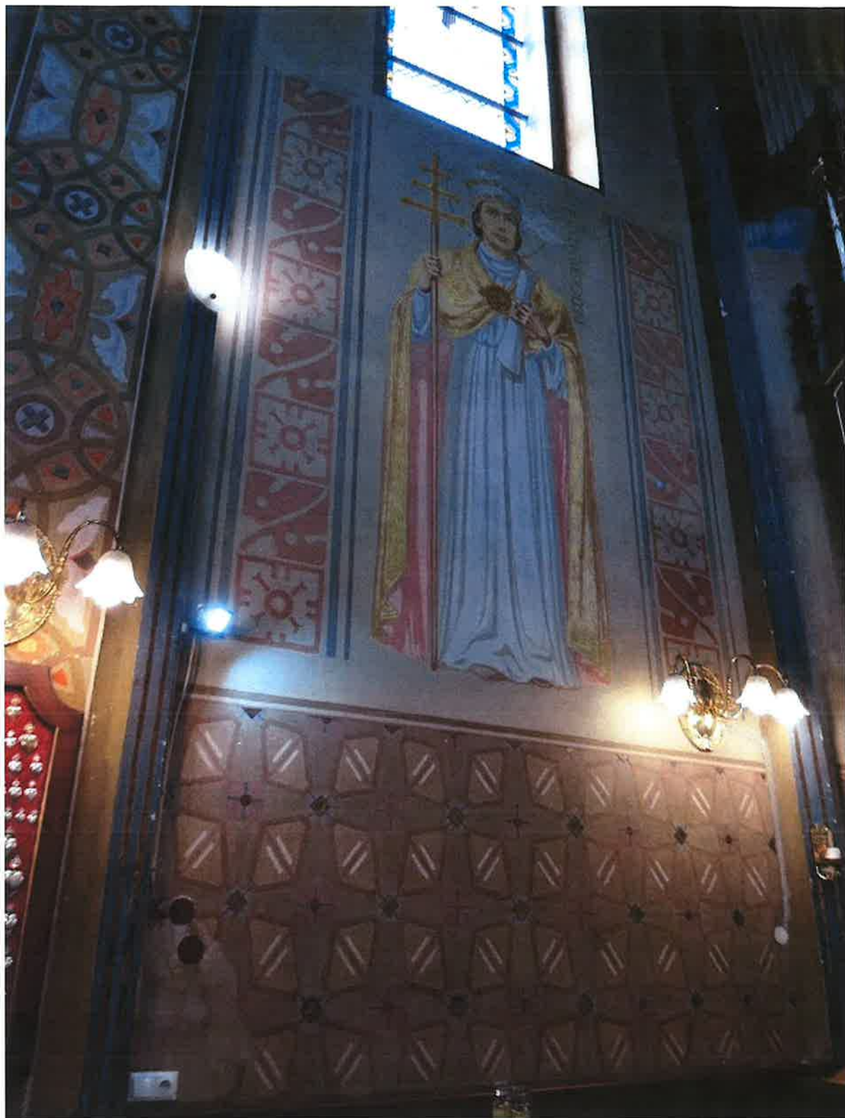
Fot. 22. Tarnawa Dolna. Kościół parafialny p.w. Św. Jana Kantego. Wnętrze prezbiterium. Fragment ściany tarczowej w sąsiedztwie ołtarza po stronie południowej z wizerunkiem dra kościoła św. Grzegorza . Widoczne zabrudzenia powierzchni polichromii oraz odpryski warstwy malarskiej i dolnej partii ściany .
