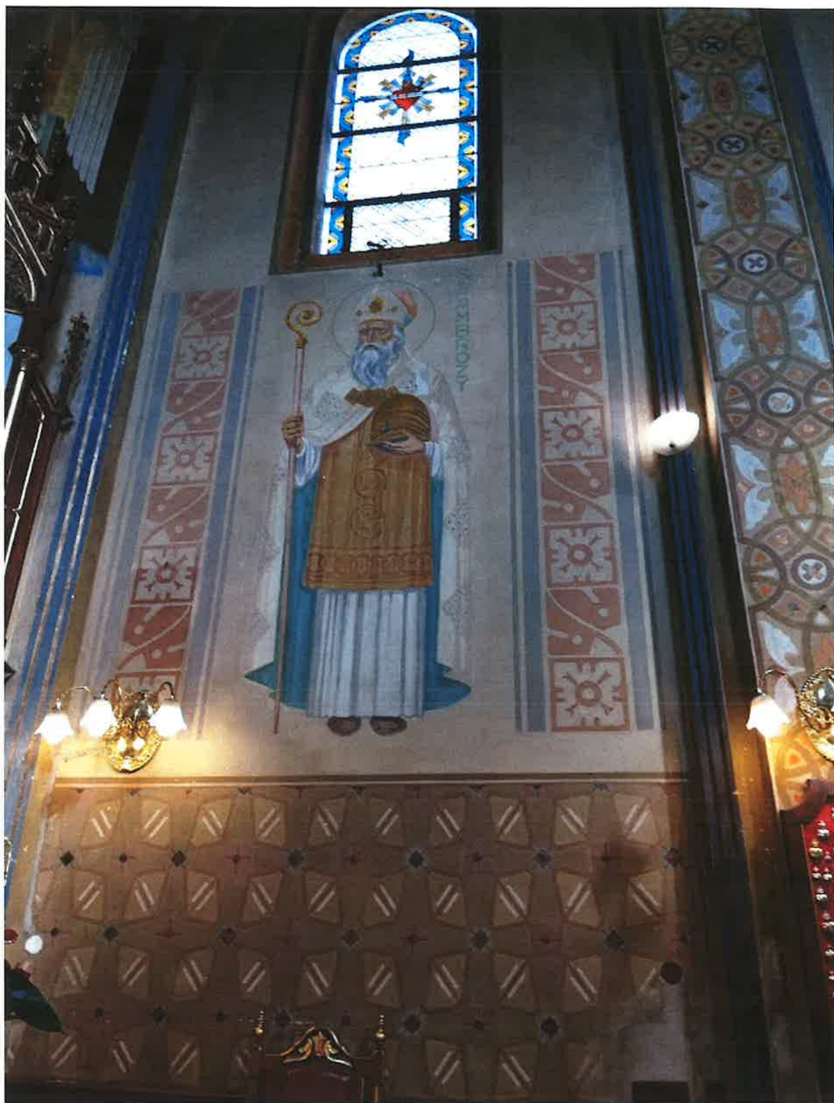
Fot. 24. Tarnawa Dolna. Kościół parafialny p.w. Św. Jana Kantego. Wnętrze prezbiterium. Fragment ściany tarczowej w sąsiedztwie ołtarza po stronie północnej z wizerunkiem dra kościoła św. Ambrożego. Widoczne zabrudzenia powierzchni polichromii oraz odpryski warstwy malarskiej i dolnej partii ściany .
