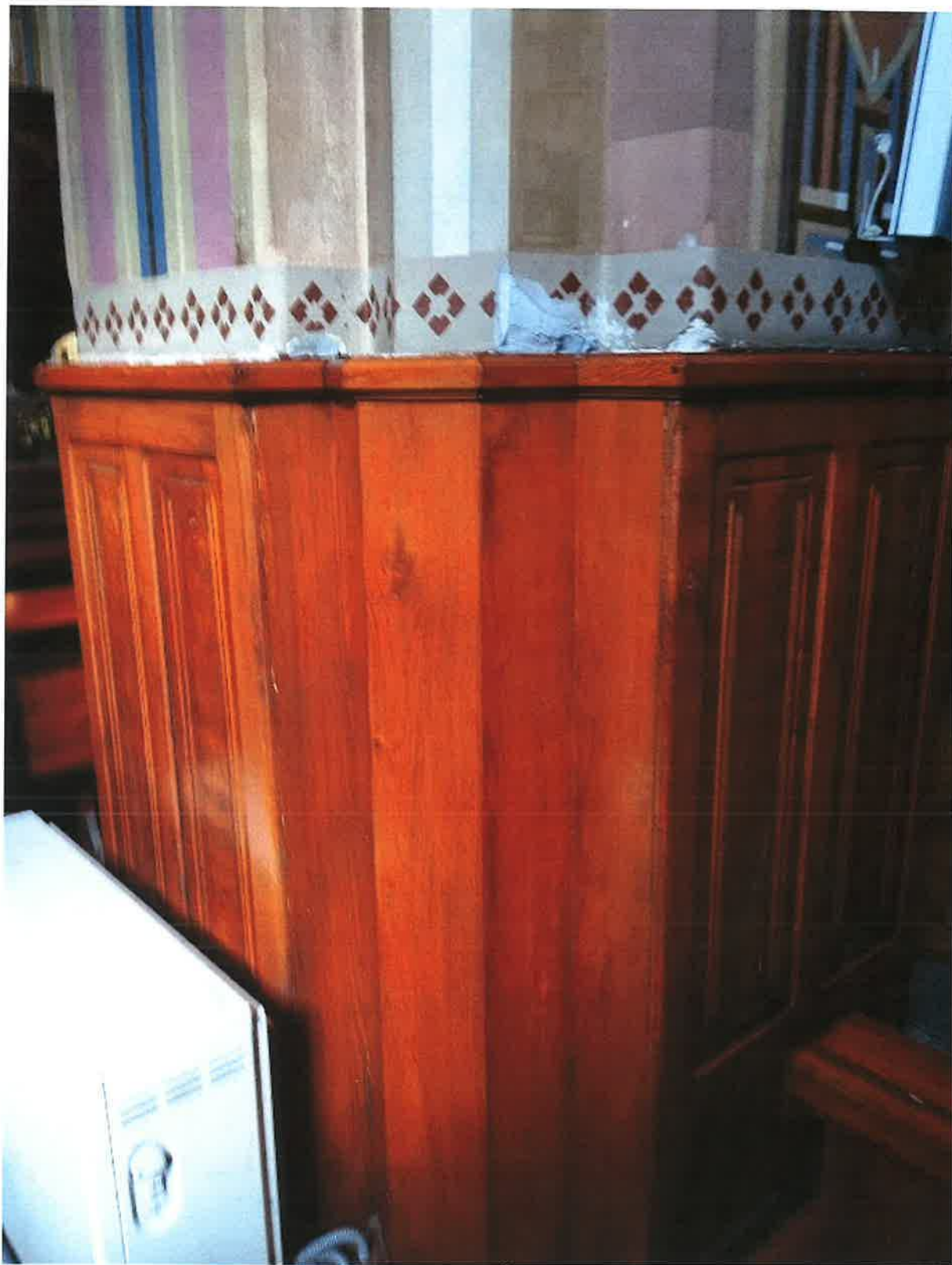
Fot. 38. Tarnawa Dolna. Kościół parafialny p.w. Św. Jana Kantego. Wnętrze. Fragment filara międzynawowego. Widoczne zniszczenia i uzupełnienia cementowe na styku z boazerią.
