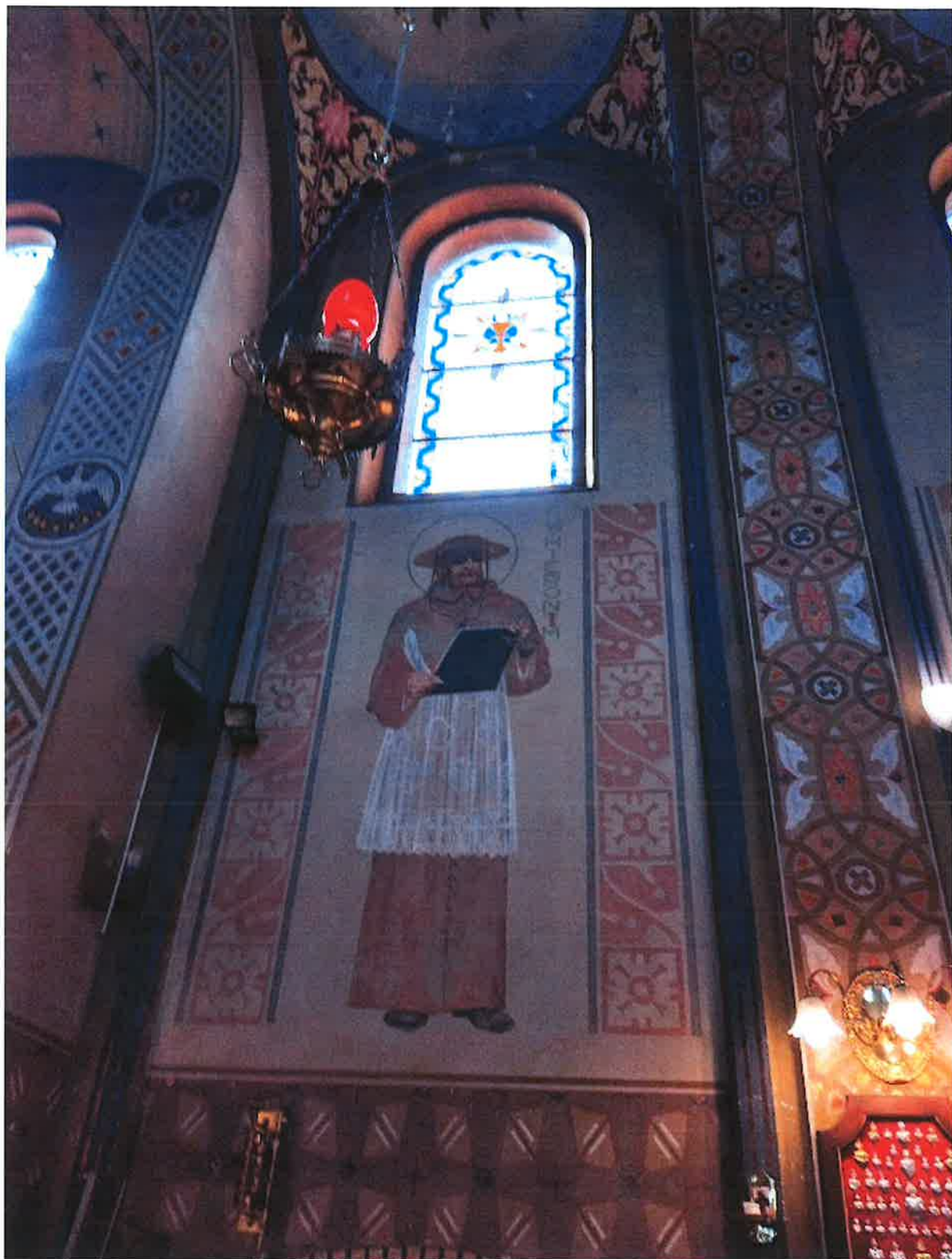
Fot. 21. Tarnawa Dolna. Kościół parafialny p.w. Św. Jana Kantego. Wnętrze prezbiterium. Ściana tarczowa w sąsiedztwie tęczy po stronie południowej z wizerunkiem dra kościoła św. Hieronima. Widoczne zabrudzenia powierzchni polichromii oraz odpryski warstwy malarskiej w szczycie i dolnej partii ściany.
