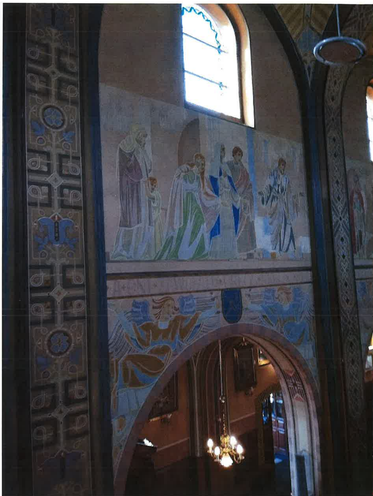
Fot. 9. Tarnawa Dolna. Kościół parafialny p.w. Św. Jana Kantego. Wnętrze. Nawa główna, ściana tarczowa po stronie północnej widoczne zabrudzenia powierzchni.
