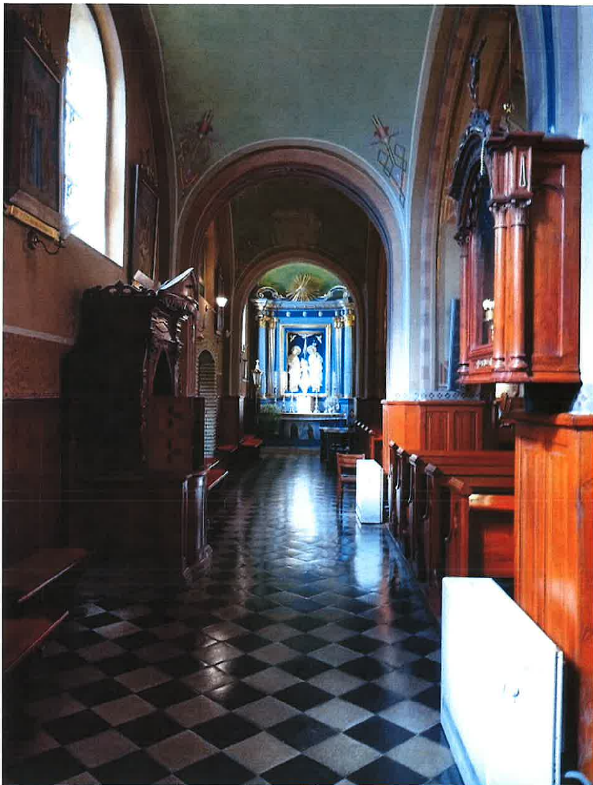
Fot. 34. Tarnawa Dolna. Kościół parafialny p.w. Św. Jana Kantego. Wnętrze. Fragment nawy bocznej po stronie północnej. Widoczne zabrudzenia powierzchni ścian i sklepień.
