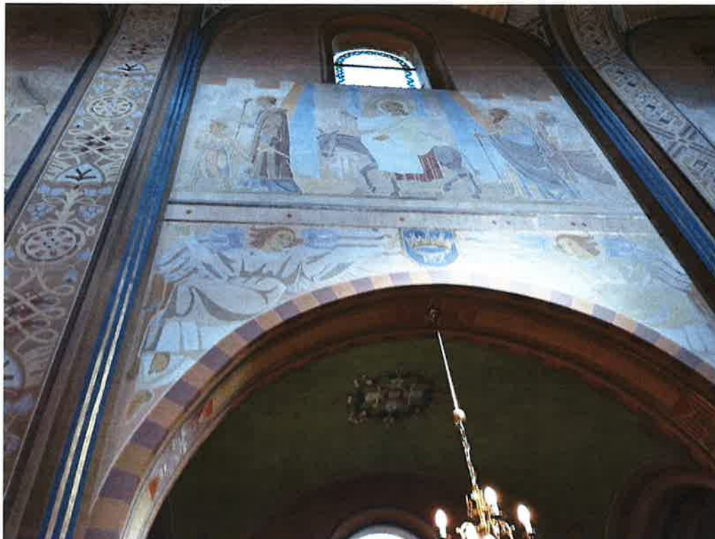
Fot. 7. Tarnawa Dolna. Kościół parafialny p.w. Św. Jana Kantego. Wnętrze. Nawa główna, ściana tarczowa po stronie południowej widoczne zabrudzenia powierzchni.
