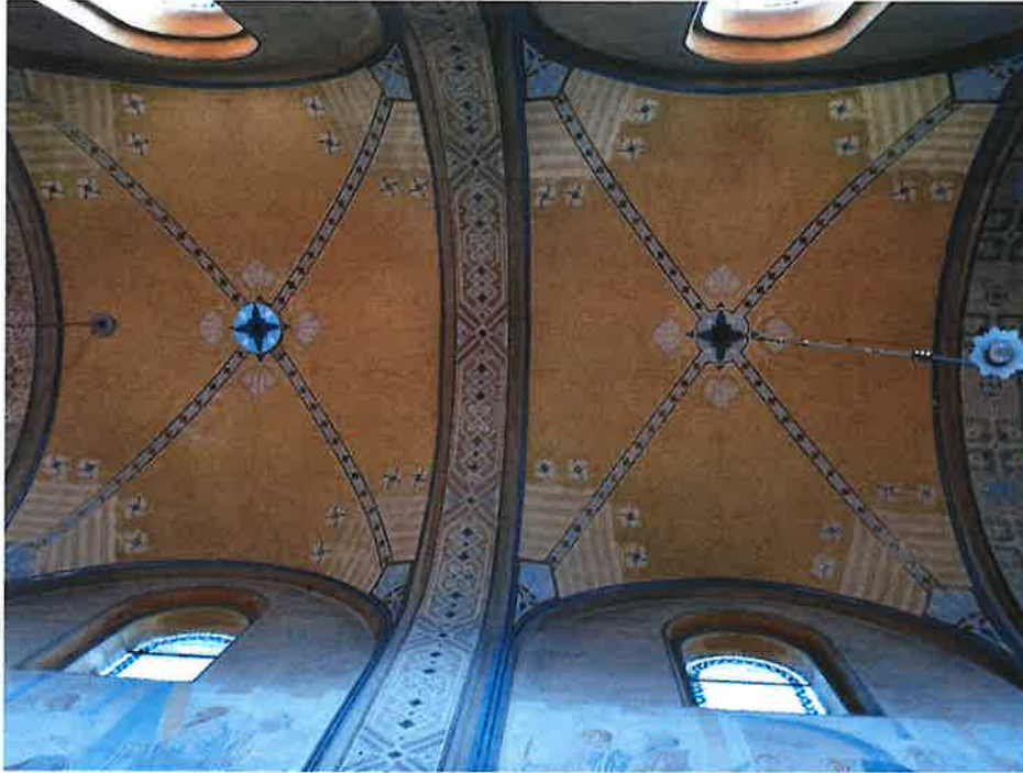
Fot. 11. Tarnawa Dolna. Kościół parafialny p.w. Św. Jana Kantego. Wnętrze. Nawa główna, fragment sklepienia. Widoczna gęsta siatka spękań tynku, zabrudzenia powierzchni dekoracji malarskiej oraz odpryski warstwy malarskiej.
