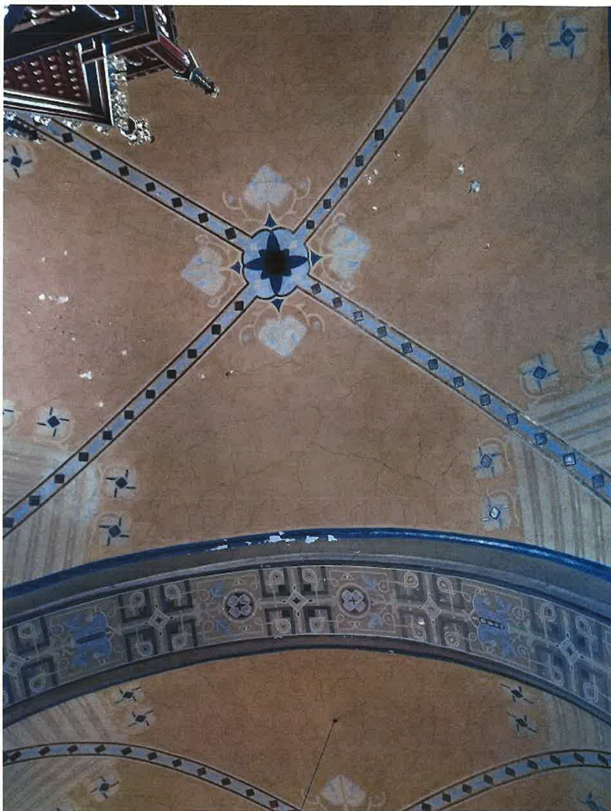
Fot. 10. Tarnawa Dolna. Kościół parafialny p.w. Św. Jana Kantego. Wnętrze. Nawa główna, fragment sklepienia nad chórem muzycznym .Widoczna siatka spękań tynku oraz złuszczające się warstwy malarskie
