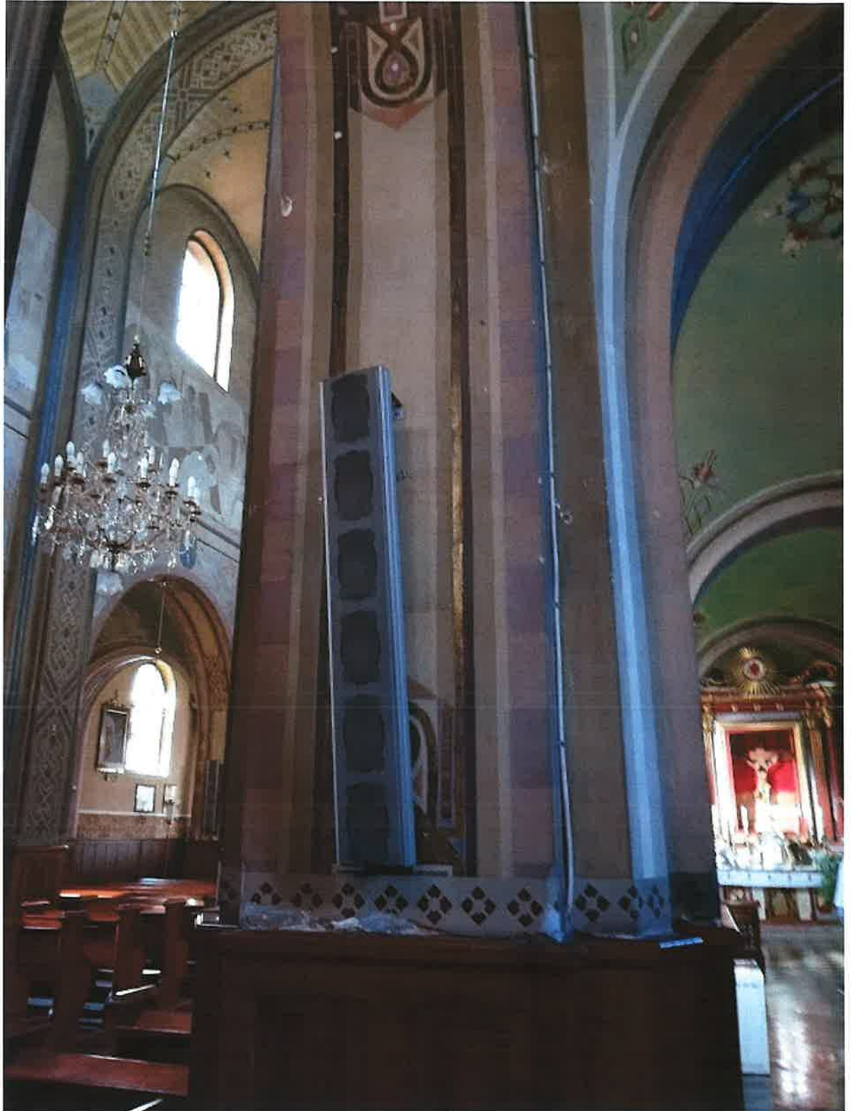
Fot. 33. Tarnawa Dolna. Kościół parafialny p.w. Św. Jana Kantego. Wnętrze. Fragment filara łuku na granicy ściany nawy głównej i bocznej po stronie południowej . Widoczne uszkodzenie malatury i tynku oraz cementowe uzupełnienia na styku z boazerią.
