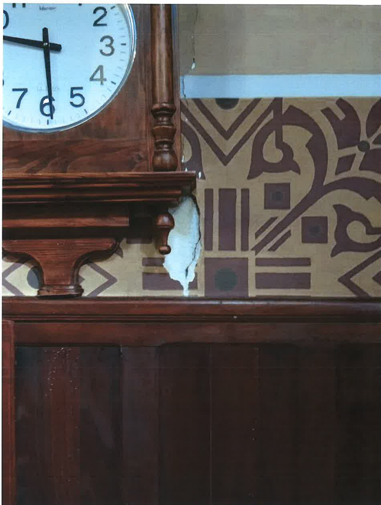
Fot. 32. Tarnawa Dolna. Kościół parafialny p.w. Św. Jana Kantego. Wnętrze. Fragment ściany nawy bocznej po stronie południowej . Widoczne uszkodzenie malatury i tynku oraz pionowe rozspojenie ściany.
