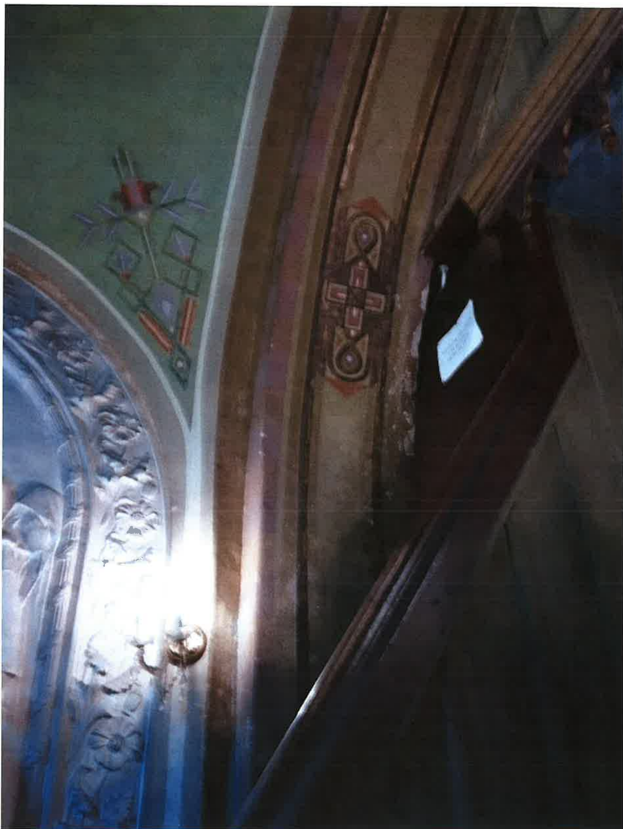
Fot. 13. Tarnawa Dolna. Kościół parafialny p.w. Św. Jana Kantego. Wnętrze. Fragment arkady prowadzącej do nawy bocznej po stronie południowej przy wejściu na chór widoczne zniszczenia warstwy malarskiej.
