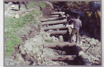
Powódź - ratowanie drogi Tarnawa Górna
