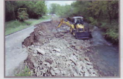
Powódź - ratowanie drogi Tarnawa Górna
