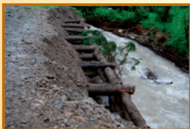
Podmyta droga w Tarnawie Górnej
