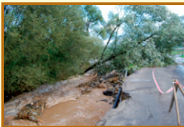
Podmyta droga pow. w Tarnawie Dol. Dół
