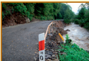
Podmyta droga pod osuwiskiem Biele
